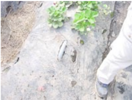
photo3. A 区各畝の散水塩ビパイプ
